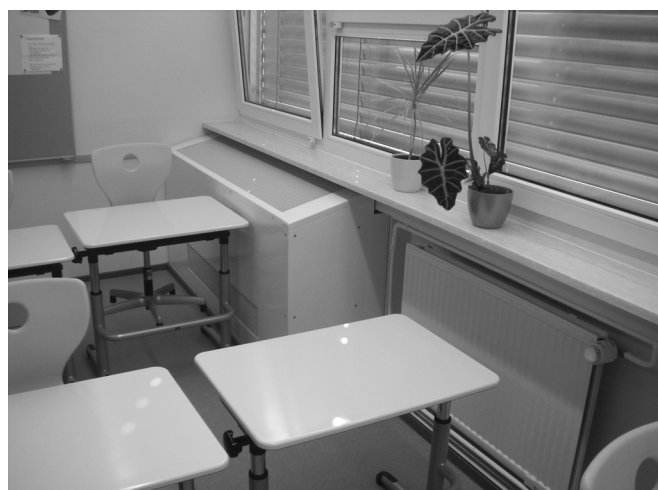
Bild 1. Eingebaute dezentrale Lüftungsgeräte im Klassenzimmer in der Schule in Nordrhein-Westfalen (oben) und in Sachsen (unten).
