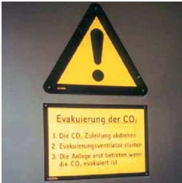
Abb. 8: Hinweise an einer gesicherten Zugangsöffnung
