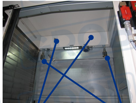
2 Wärmemelder im Arbeitsraum
