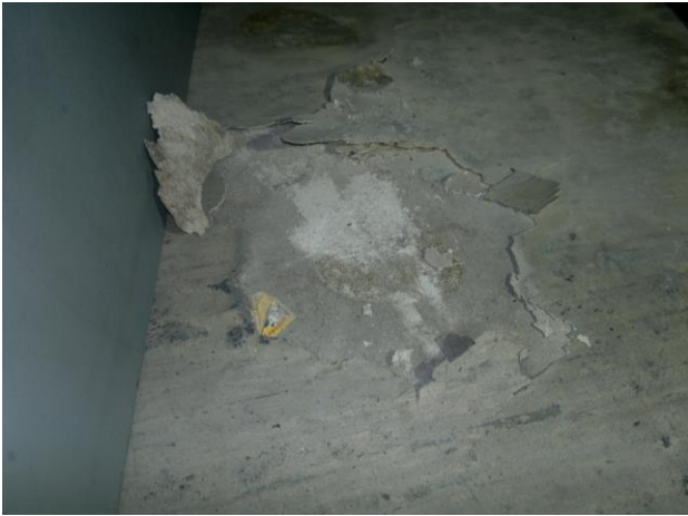
Bild 18: Asbesthaltiger Rücken des Bodenbelages
