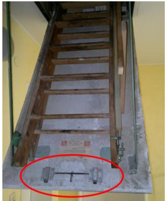
Bild 5: Einschubtreppen als Zugang zum Triebwerksraum mit Abriebspuren durch die Benutzung an der Asbestplatte des Lukendeckels
