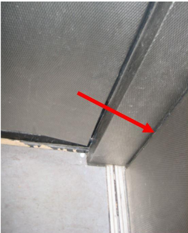
Bild 19: Asbestzementplatten hinter der Kabinenverkleidung (im Bild nicht sichtbar)
