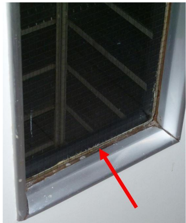
Bild 22: Asbesthaltige Dichtung an Türverglasung
