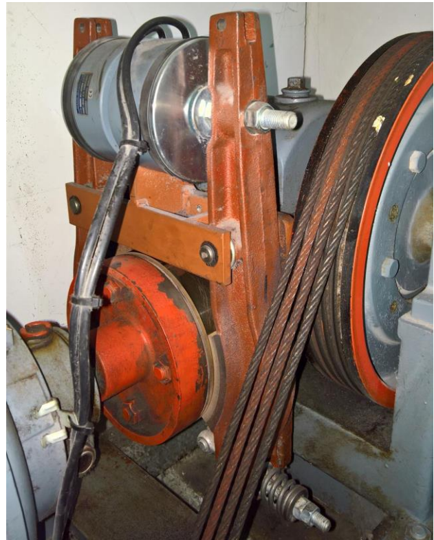
Bild 11: Anlage mit erneuerter Bremse
