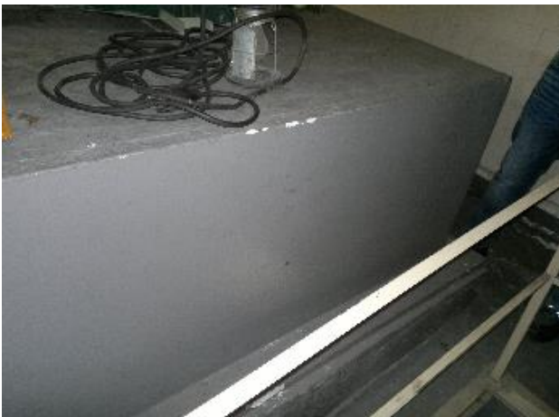
Bild 9: Mit Farbe überstrichene asbesthaltige Leichtbauplatten als Abdeckung
