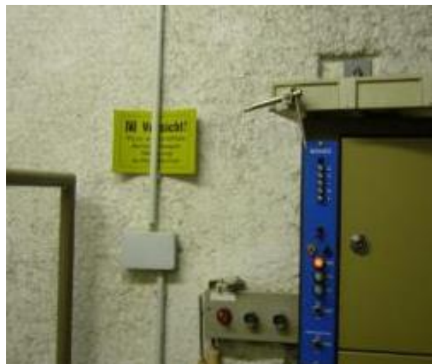
Bild 6: Mit Spritzasbest beschichtete Wand in einem Triebwerksraum
