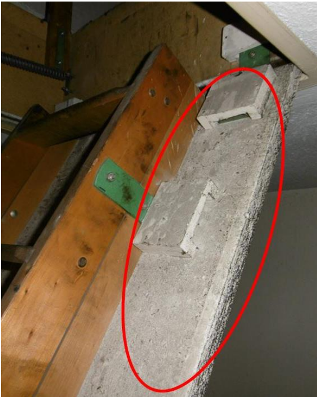
Bild 3: Mit asbesthaltiger Leichtbauplatte beplankter Lukendeckel zum Triebwerksraum
