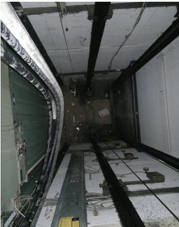
Bild 8: Mit Asbestplatten verkleideter Aufzugsschacht
