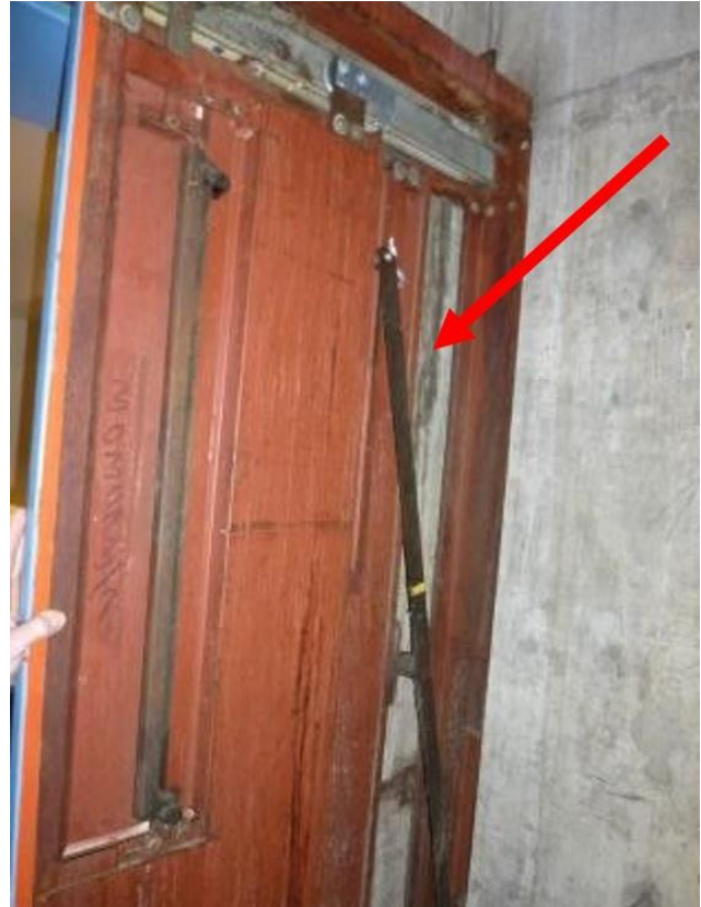
Bild 21: Asbesthaltige Leichtbauplatte bzw. asbesthaltige Pappe zwischen den Türwandungen
