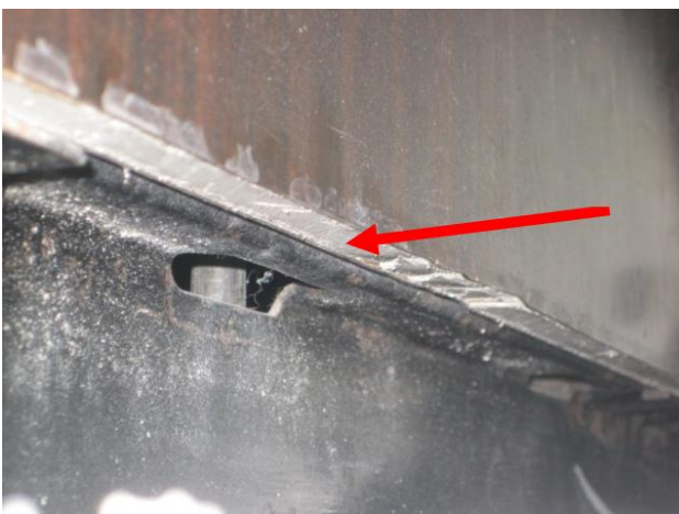
Bild 20: Asbestzementplatten hinter der Kabinenverkleidung
