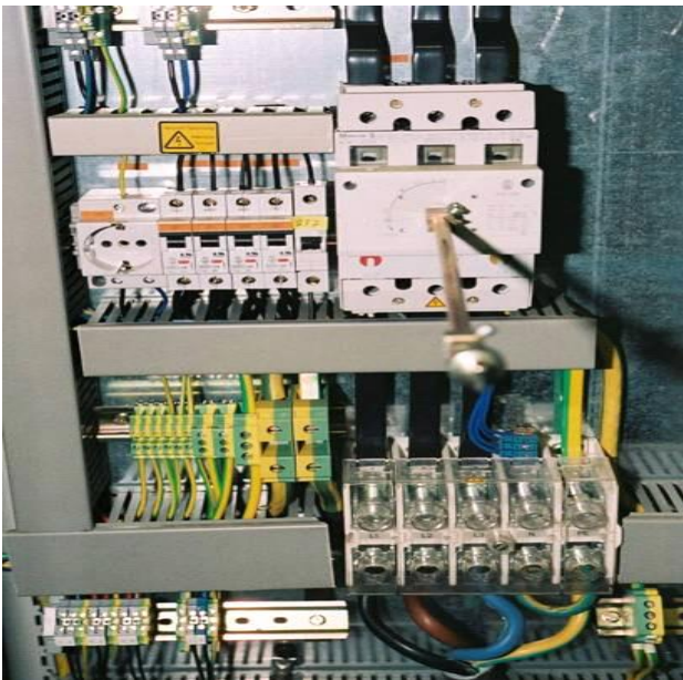
Bild1: Elektrische Ausrüstung einer Maschine.
