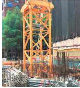
Abb. 11: Beispiel für einen Kranaufstieg
