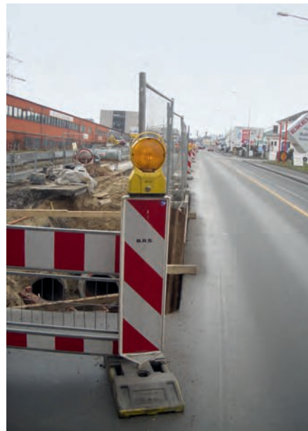
Abb. 2: Kanalbaustelle zu dicht an der Straße und unverbaut
