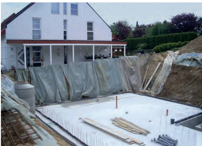
Abb. 1: Standsicherheit der Baugrubenwand und des Gebäudes möglicherweise gefährdet, Standsicherheitsnachweis für Gebäude und Baugrubenwand erforderlich
