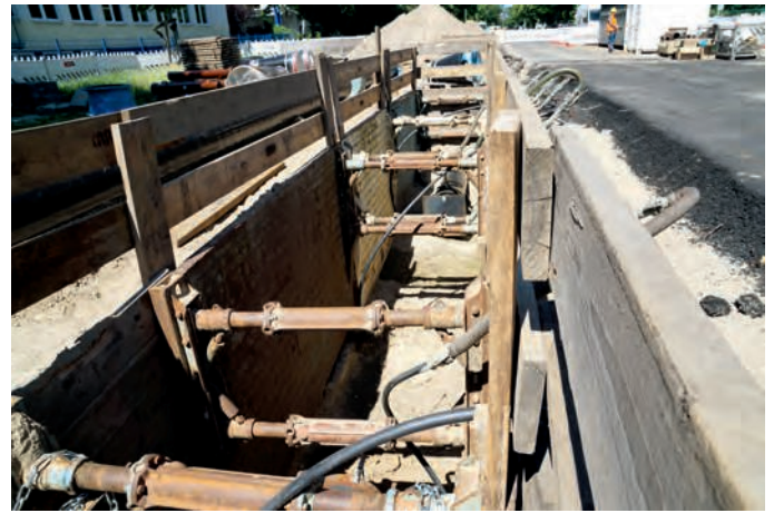
Abb. 12: Absturzsicherung am Rohrleitungsgraben (auf ausreichende Dimensionierung ist zu achten)
