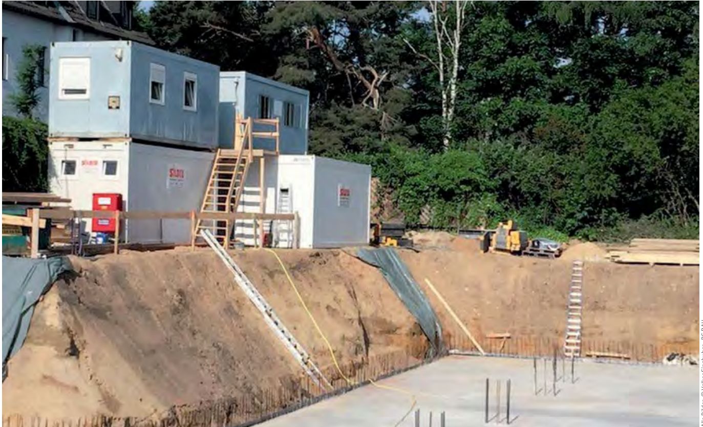
Die Auflast durch Container am Böschungsrand ist zu hoch und deshalb nicht zulässig. Zudem sind die Böschungen zu steil und fehlen Absturzsicherungen und Abdeckungen für Bewehrungsseisen.
