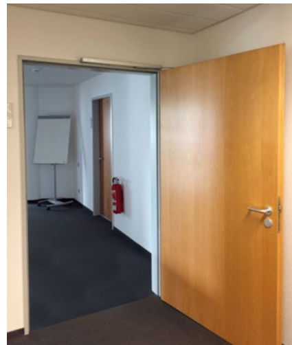
Abb. 10 Offen gehaltene Feuer- und Rauchschutztür
