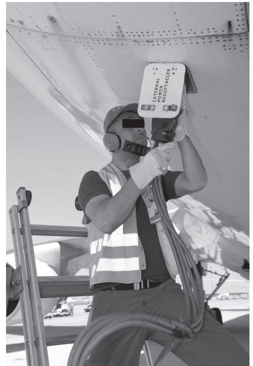
Bild 2. Anschluss der Bodenstromversorgung.
