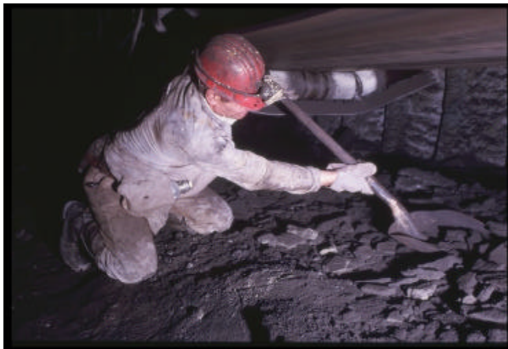
Abbildung: Säubern unter stillgesetzten Bandanlagen im untertägigen Bergbau
