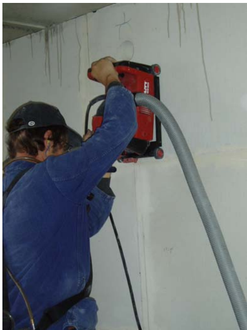
Abbildung 1: Bei Arbeiten mit Mauernutfräsen entstehen für Beschäftigte gesundheitsgefährdende Stäube
