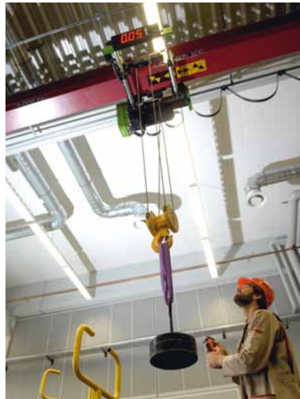
Mehrzweckhalle: Fahrtraining mit Brückenkran
